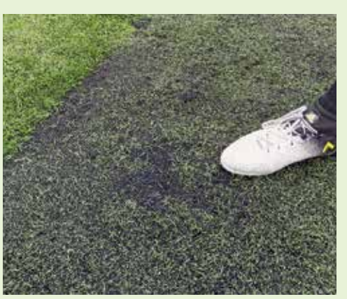
8年経ち、あちらこちらに綻びが(左上は部分張り替え)
